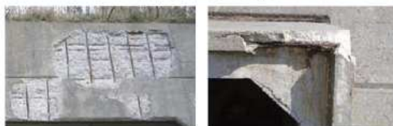
中性化による被害状況
