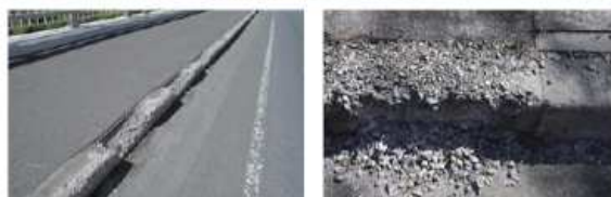
凍結融解による被害状況
