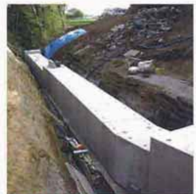
狭隘な場所の落差工でのボックスカルバート搬送・据付け工法
